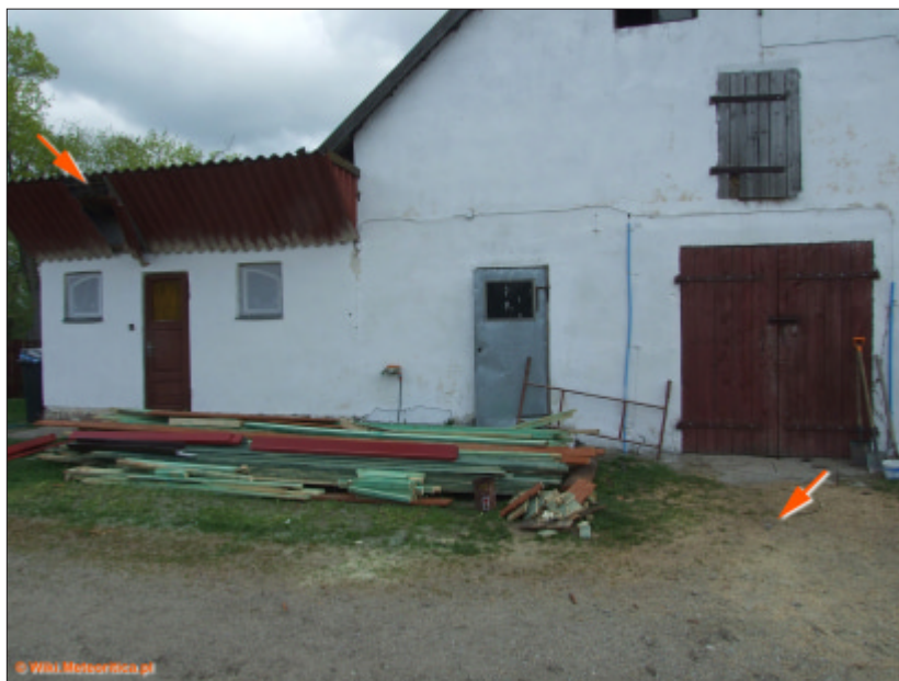
Dziura w dachu i miejsce znalezienia masy głównej. Fot. Jan Woreczko.
