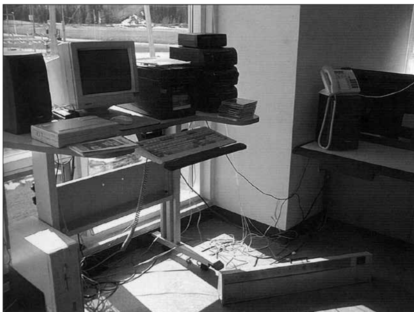
Zjadający napięcie ogrzewacz na podłodze w podstacji Yukon Electric w Whitehorse. Rejestrator stoi z prawej strony monitora.
